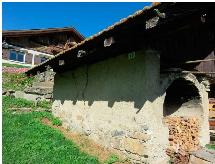
Vue 1. Le Bettey d'en Bas, Fissure verticale à l'axe du mur gouttereau. Probable glissement de l'avant du four, lié à la topographie importante du terrain. A renforcer par pose d'agrafe, ou tirants et colmatage
