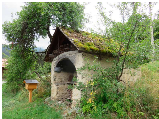
Vue 3. 1352 Route du Bettex, couverture en tavaillon ruinée, défaut d'étanchéité. A restaurer.
