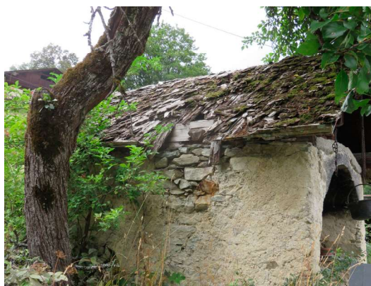
Vue 4. 1352 Route du Bettex, couverture en tavaillon ruinée, défaut d'étanchéité. A restaurer.
