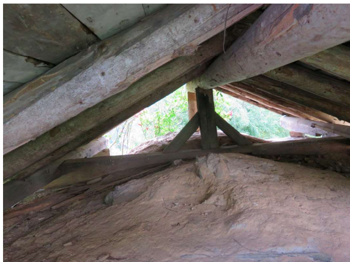
15 Route de la Croix, calage en terre fine sur la voûte pour maintenir la chaleur
