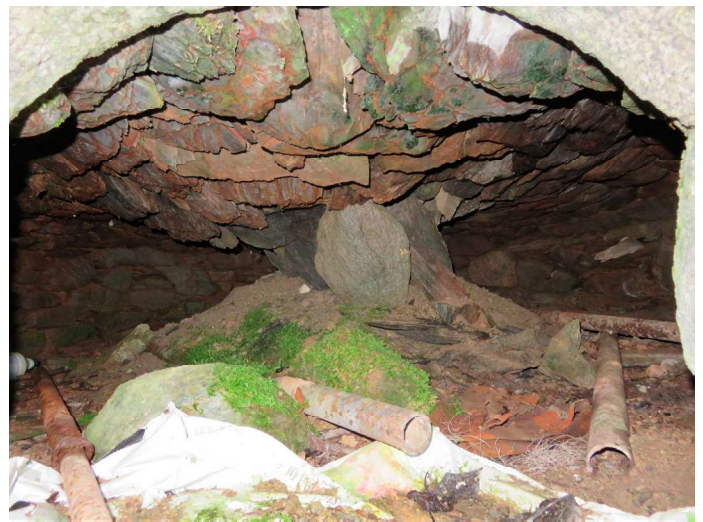
Vue 2. 51 Chemin du Cey, Effondrement de la voûte, absence de toiture. Déblaiement, dépose pour reconstruction
