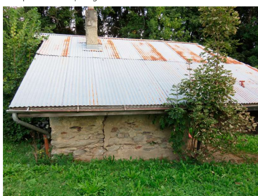
Vue 6. 2028 Route des Ponthieux, remplacement de la couverture par de la tôle ondulée, A restituer en ancelles + pierres plates
