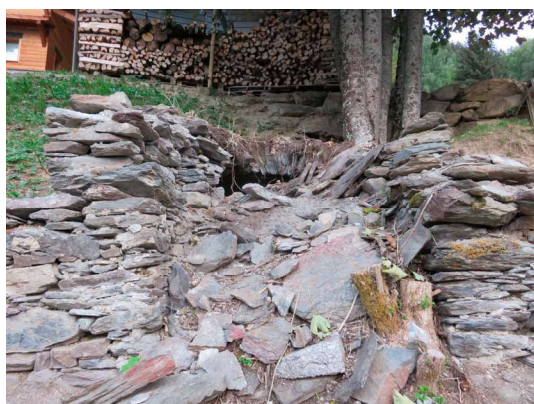
Vue 1. Le Mellerey, Manque de toiture, ruine
