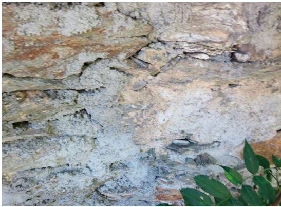
Vue 1. Le Cey, reprises d'enduits au ciment
