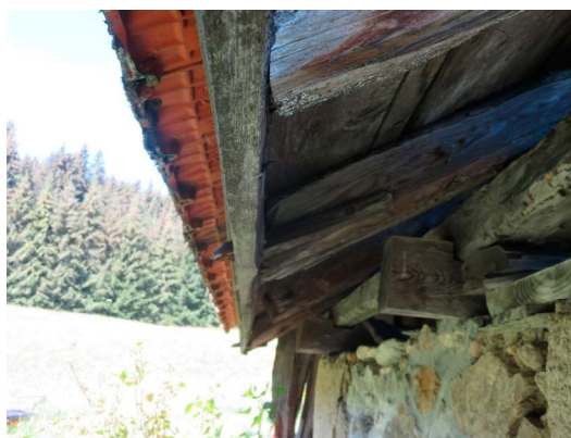
Vue 5. 401 Route de l'Emey, about de chevrons abîmés, remplacement par greffe
