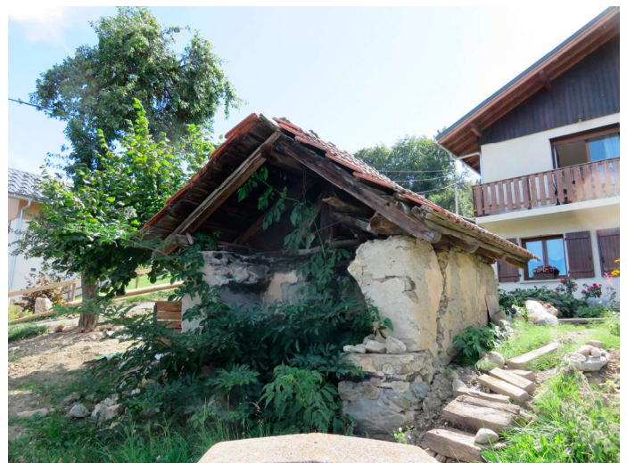
Vue 3. Route de Cupelin. Dépose de l'auvent, fissure importante et désolidarisation du mur gouttereau. Phénomène accentué par la pente. Pose d'agrafe, scellement au mortier de chaux, colmatage au mortier chaux.
