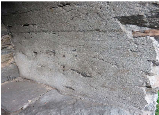
Vue 2. 324 Route du Parc. Traces des coffrages de la voûte d'entrée; Manques d'enduits, à colmater
