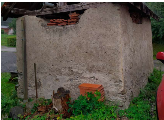
Vue 3. Le Poirier Enduits pulvérulents en bas de murs dues aux remontées capillaires, à restaurer
