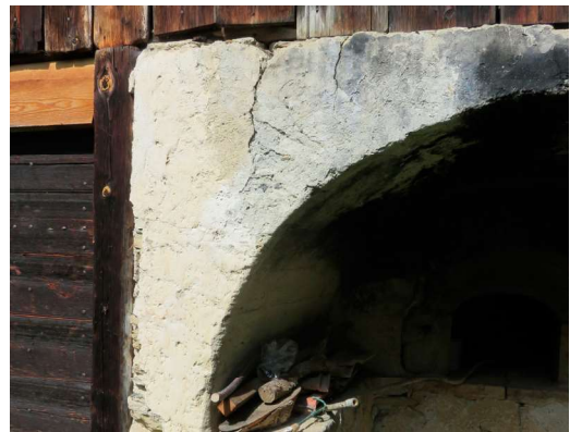
Vue 5. 1454 Route de La Croix. Traces de badigeons et enduits pulvérulents. A restaurer
