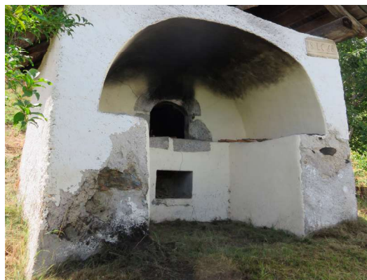
Vue 6. 489 chemin du Thovex. Enduits inadaptés pulvérulents dues aux remontées capillaires
